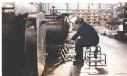
ICI Caldaie S.p.A., Zevio (VR)
